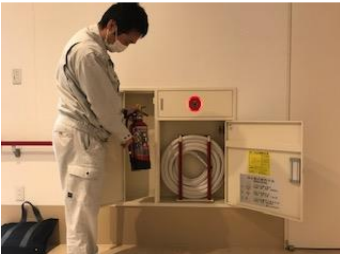
消火器取扱説明
