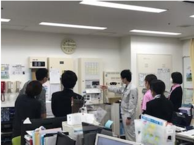
防災監視盤説明
